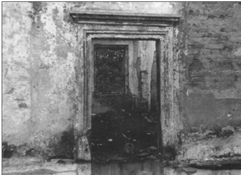
Takie XVI-wieczne portale kamienne wyrwali z murów i wyrzucali na zniszczenie (po pożarze w 1968 r. – fot. Autor)
